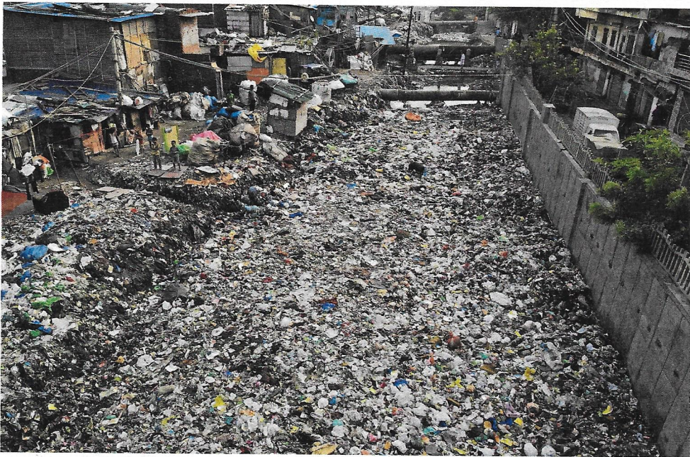
Abwasserkanal in Neu-Delhi: Müll verstopft Abflüsse, führt zu Überflutungen und Seuchen
